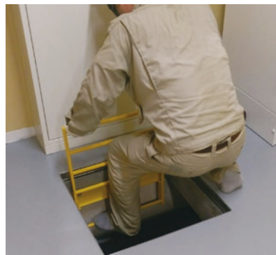
ピット内に昇降用タラップを追加で設置することをお勧めいたします。
